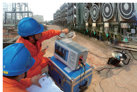
中国南方电网溪洛渡送广东双回直流工程变压器测试现场
